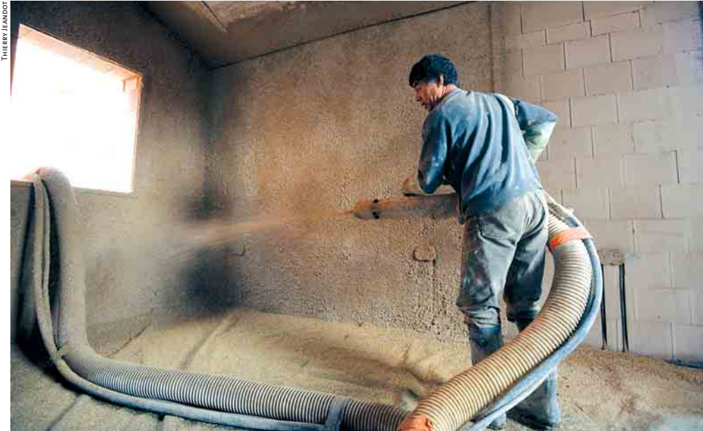
Hervé Derrien, gérant de Terrachanvre, fait une démonstration de l'efficacité de sa machine à projeter un mélange de chaux et de chanvre, dans l'un des bungalows en construction au camping de Caurel.
